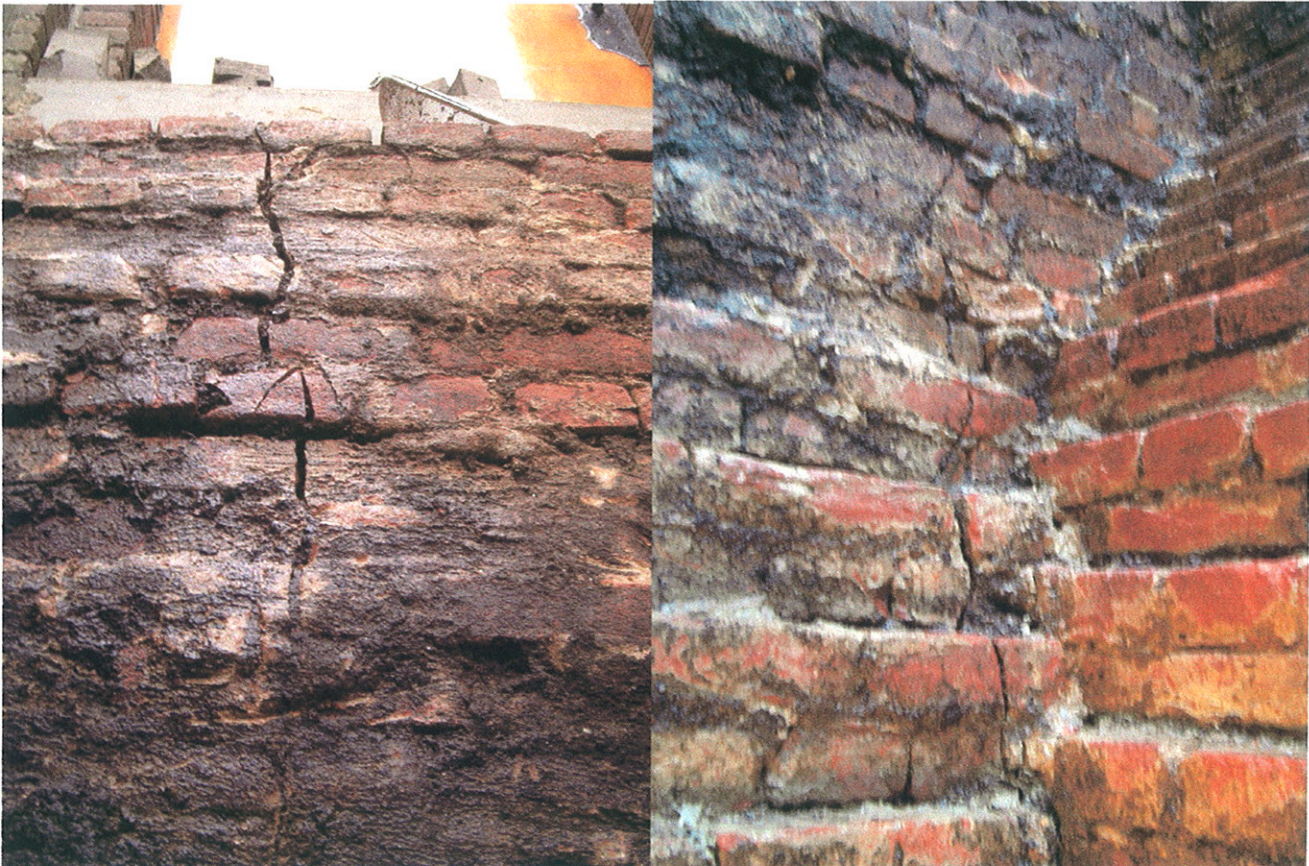
Foto's 2 en 3: Overzicht funderingsmetselwerk. Links een scheur die loopt vanaf onderkant funderingsmetselwerk tot de linker zijde van het portaal. Rechts een scheur die loopt van onderkant funderingsmetselwerk tot de rechter zijde van het portaal.
