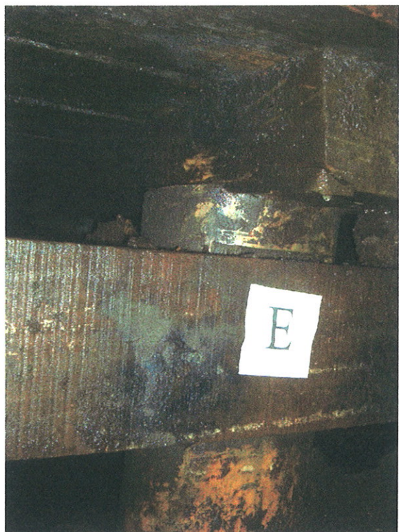
Foto 8: Paal E met kesp K4. Het balk, B5, die langs de voorkant van het paal ligt maakt deel van de herstellende structuur welk in de jaren 1960 aangebracht is.
