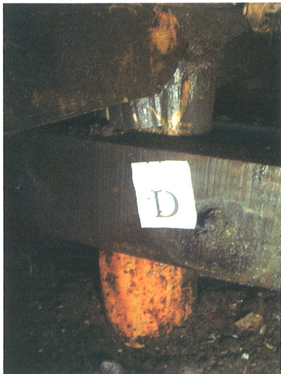
Foto 7: Kesp K3 boven palen D. Het indringing van de paal kop in de kesp is duidelijk te zien. Het balk, B5, die langs de voorkant van het paal ligt maakt deel van de herstellende structuur welk in de jaren 1960 aangebracht is.
